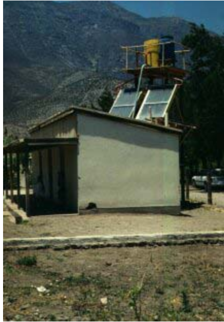
Foto 3: Sistema agua caliente solar al interior de Cabildo. Calienta 400 litros de agua al día
