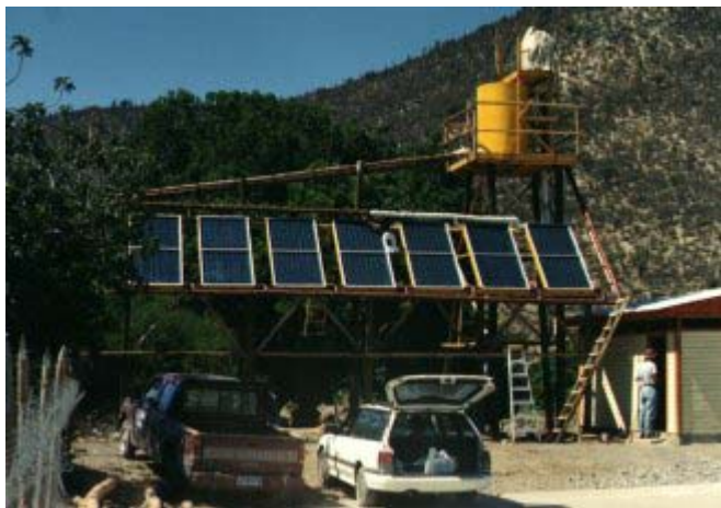
Foto 2: Sistema de agua caliente para escuela en La Viña (Cabildo). Calienta 2000 litros de agua al día
